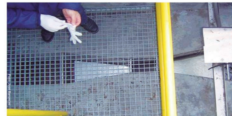
Vista de un aforador Parshall
